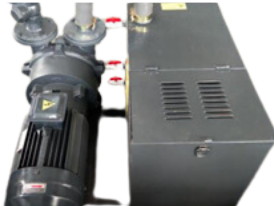
Bomba de Vacuo 11KW
